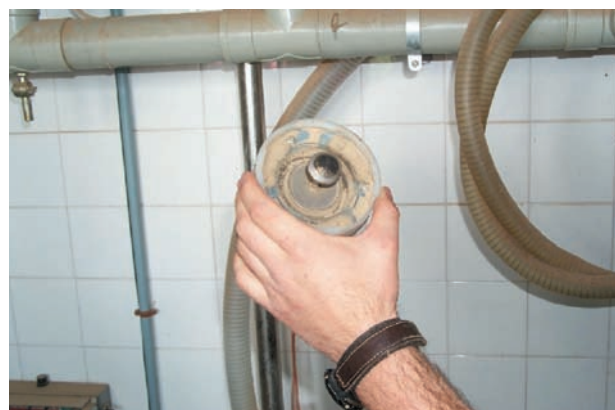
Figura 5. Suciedad en el regulador. (Fotografía: Jorge Gutiérrez, ANCHE)
